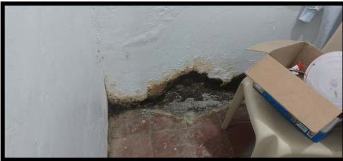
Fuente: Consultorio RX – Humedad en la pared sala de control
