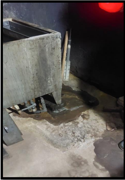
Fuente: Consultorio RX – Tanque de revelado
