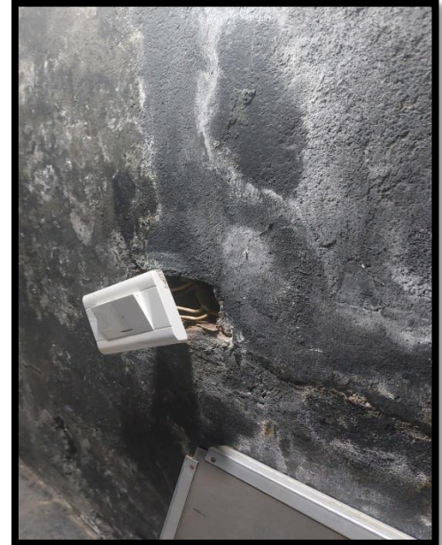
Fuente: Consultorio RX – Sala de revelado conexión eléctrica
